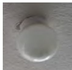
Εικόνα 5: Φωτιστικό επίτοιχο στις τουαλέτες του ισογείου.
