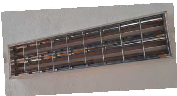
Εικόνα 2: Φωτιστικά φθορίου T8 σε ανακλαστήρες στη βιβλιοθήκη.
