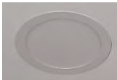
Εικόνα 8: Φωτιστικό οροφής τεχνολογίας LED, ισχύος 20 W, στη Βιβλιοθήκη του Λυκείου.
