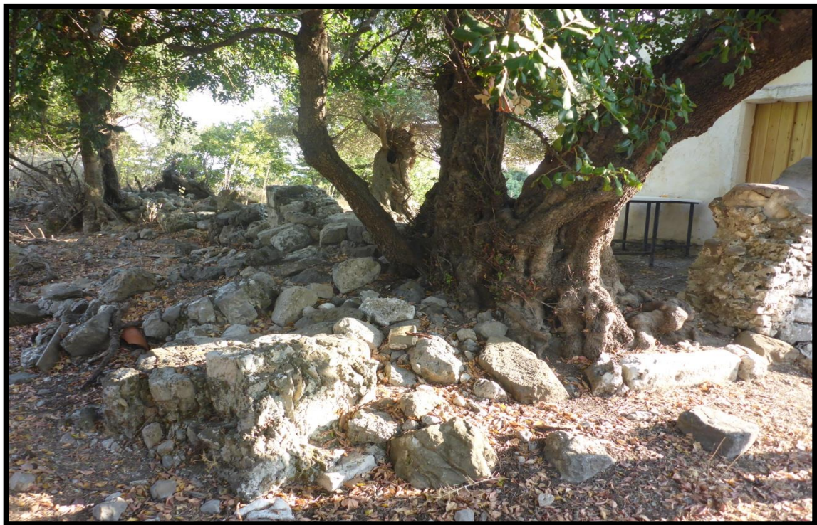
Πετρόχτιστο τοίχιο πίσω από την εκκλησία Άγιο Νικόλαο που χρήζει ανακατασκευή
