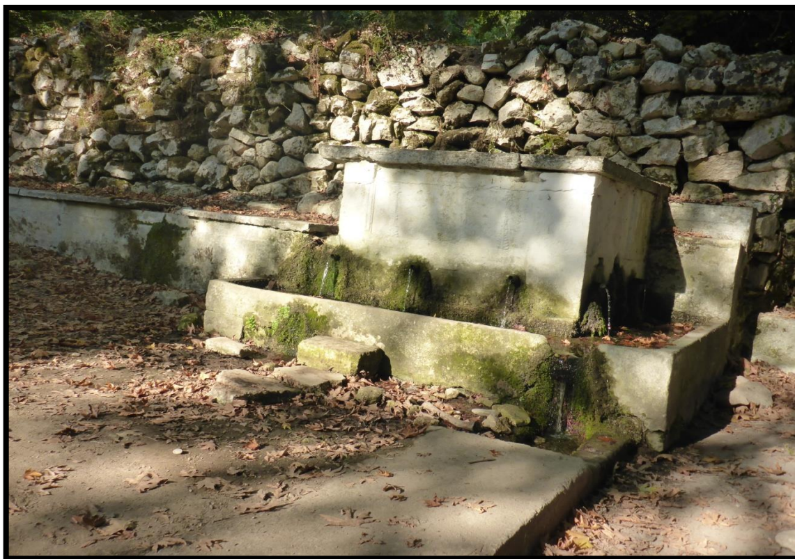
Πέτρινες βρύσες που θα αποκατασταθούν με αμμοβολή και αριστερά αυτών τοιχίο που χρήζει επιδιόρθωση
